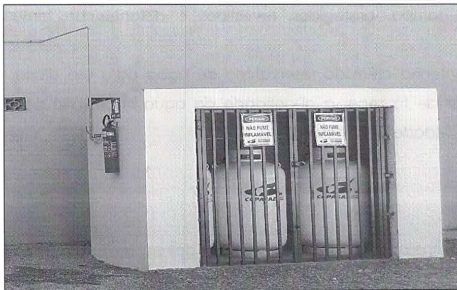
Central de gás GLP
