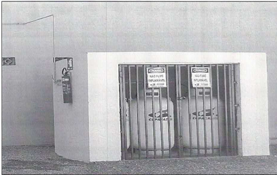
Central de gás GLP
