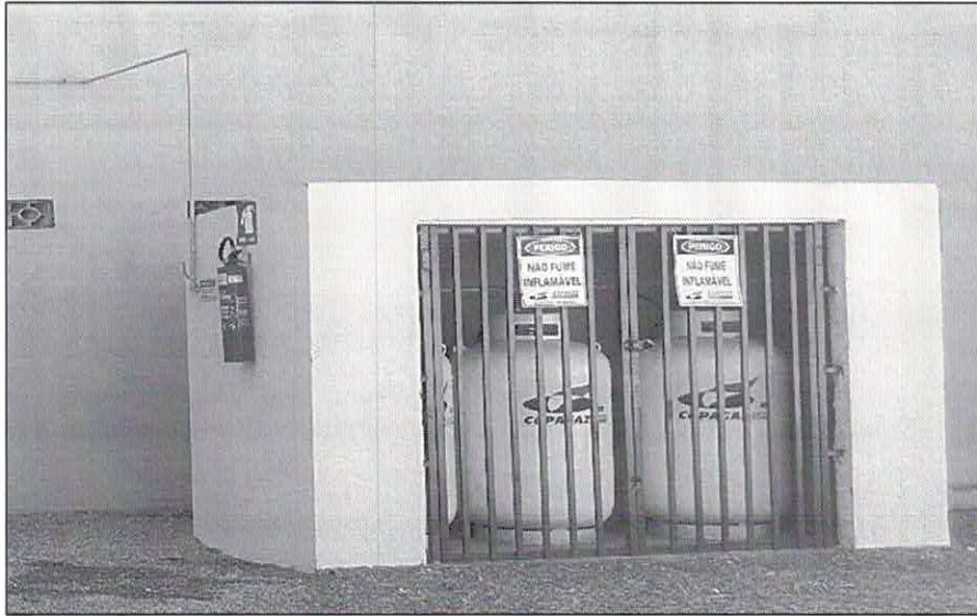
Central de gás GLP
