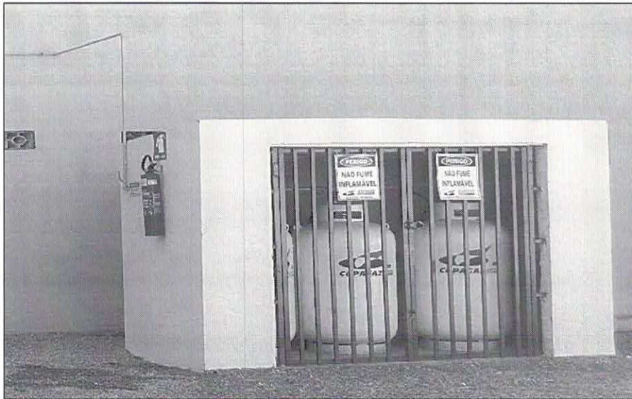
Central de gás GLP
