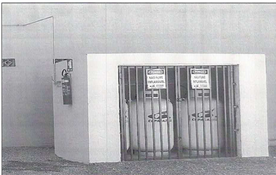
Central de gás GLP
