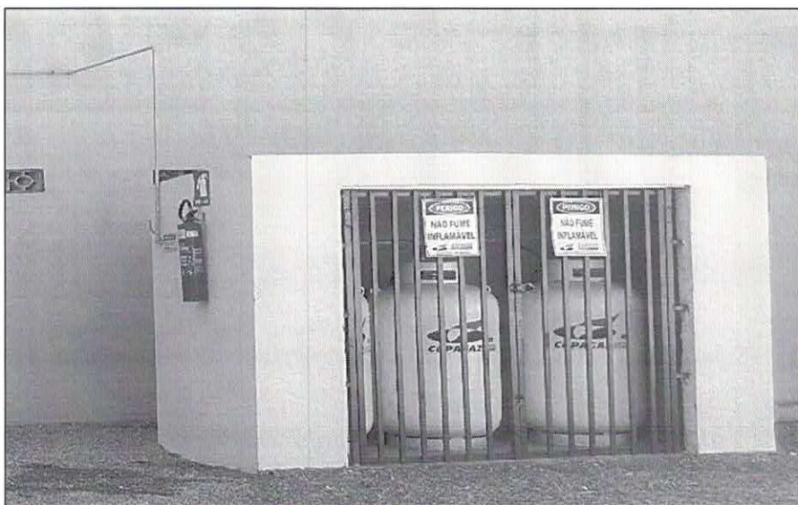
Central de gás GLP
