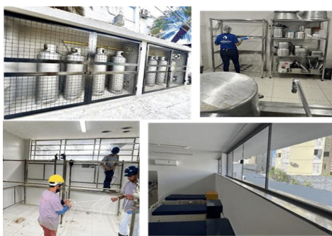
Melhorias da estrutura da Casa do Interior: Nova central de gás, aquisição de prateleiras de aço inoxidável e reforma da ala masculina.
