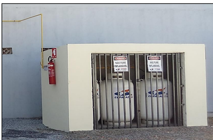
Central de gás GLP
