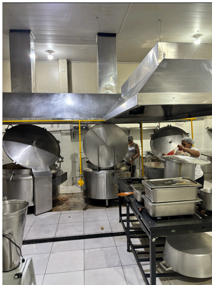
Cozinha - preparo das refeições - Panelas elétricas e fogão a gás.
