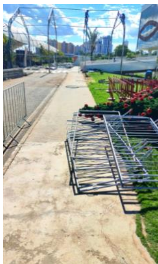
Entre o recolhimento de gradis e o desmonte das coberturas, o cenário do Natal do Bem muda durante a desmontagem
