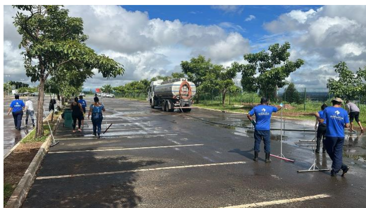
Equipe finalizando os últimos detalhes da lavagem para realizar uma entrega impecável: qualidade e compromisso em cada espaço
